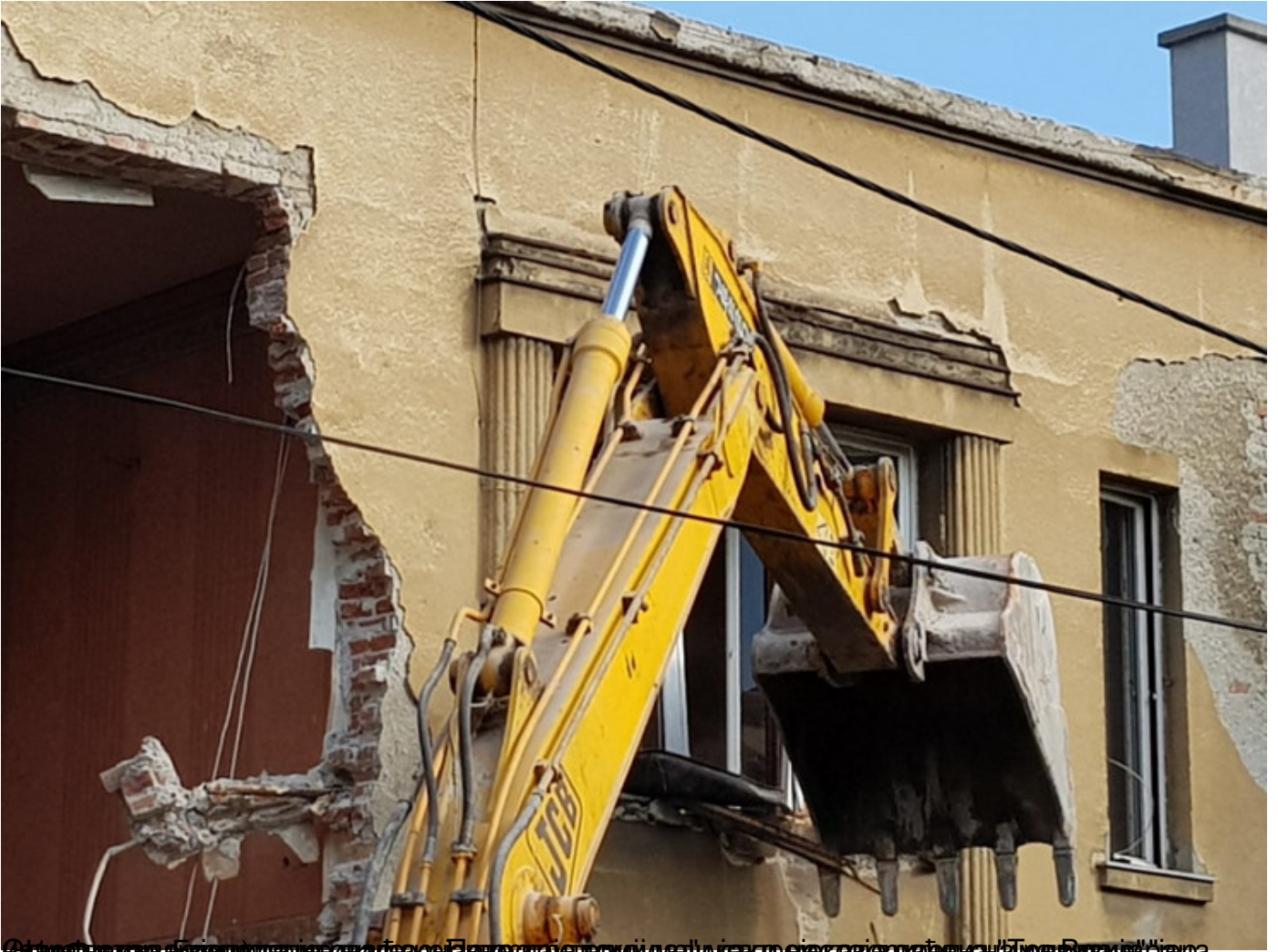
Демонтажа фасаде виле из 1927. године у Тополској улици, која важи за први пројекат у Врачура, Београд.
